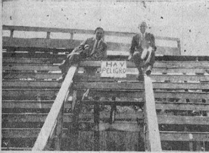
La gradería de nuestro Estado se encuentra en condiciones no muy seguras y los encargados de su cuidado colocaron un artístico rótulo que dice: Hay peligro!
